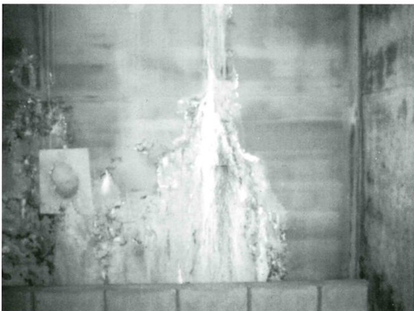
写真 地下壁面からの漏水
